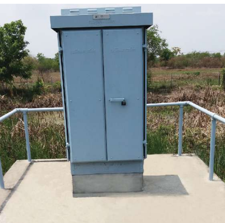
“ตู้อุปกรณ์ควบคุมระบบอาณัติสัญญาณ”
